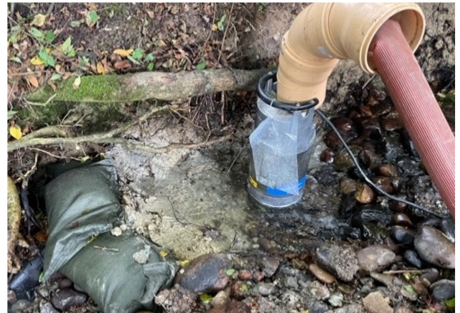
Abb. 9: Pumpensumpf mit Lehm und Sandsäcken abgedichtet.
